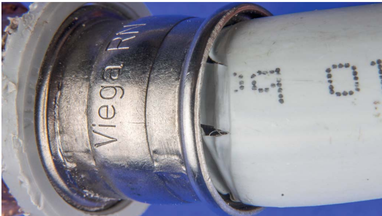
Bild 6: Nach einer ordnungsgemäßen Verpressung ist es durch eine übermäßige Dehnungsbeanspruchung des Rohrwerkstoffes zur Rissbildung gekommen
