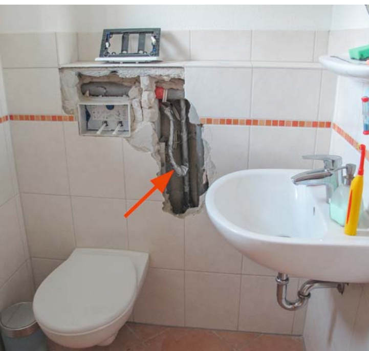
Bild 1: Die Schadenstelle befand sich hinter dem verfliesen Vormauerwerk. Der rote Pfeil zeigt auf die gefundene Undichtigkeit
