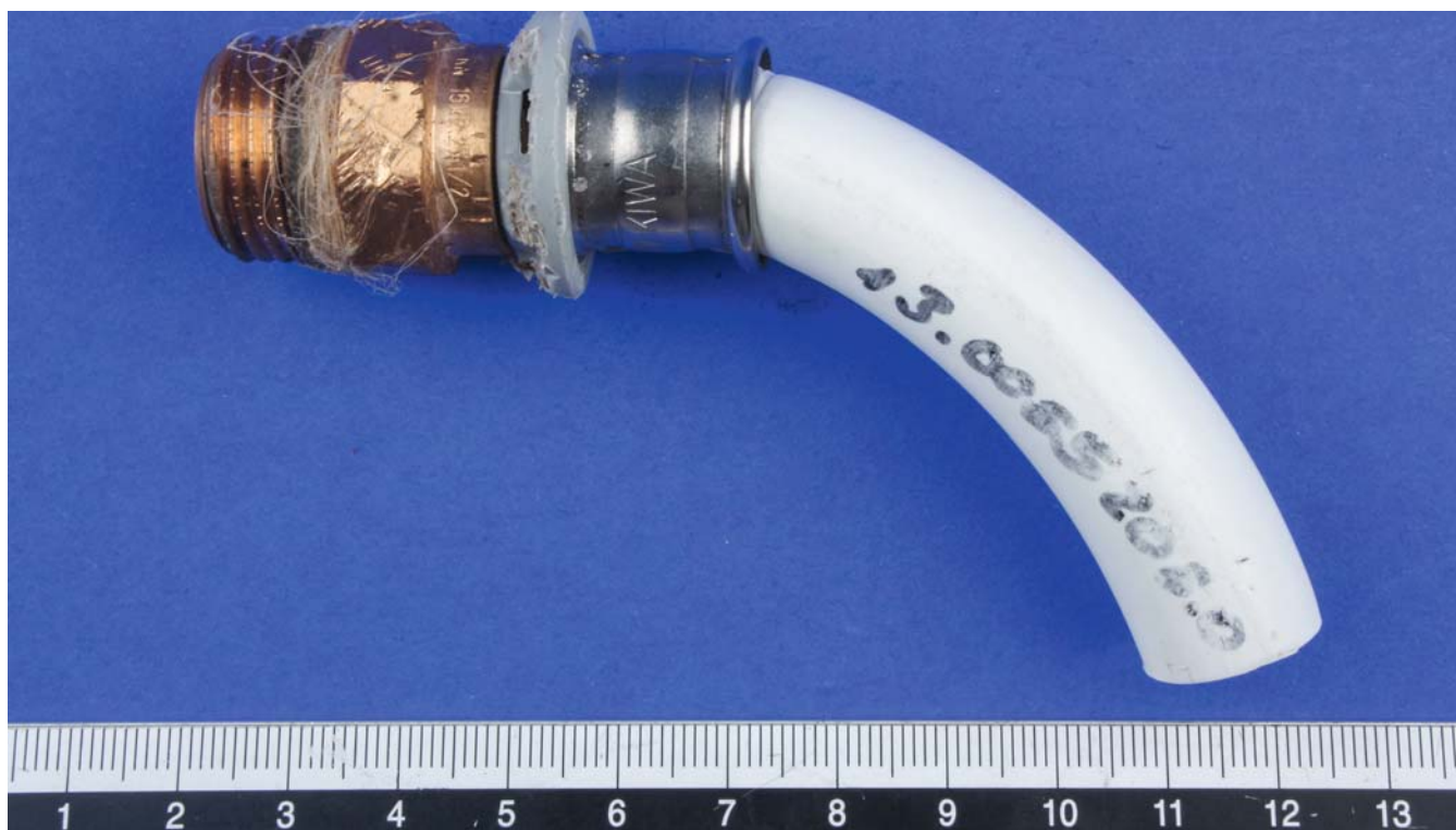
Bild 5: Das Rohrmaterial wurde hinter der Pressverbindung unzulässig umgebogen. Unmittelbar am Ende des Fittings ist der zulässige Biegeradius des Rohres unterschritten
