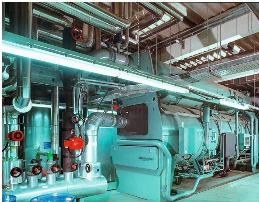
Eine Absorptionskältemaschine in der Praxis
