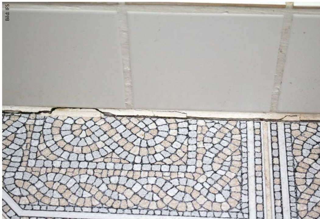
Bild 2: Die Fuge im Bad ist nicht mehr dicht. Von hier kann Wasser in das Bauwerk gelangen. In diesem Fall führte das zum Pilzbefall der darunter liegenden Holzkonstruktion
