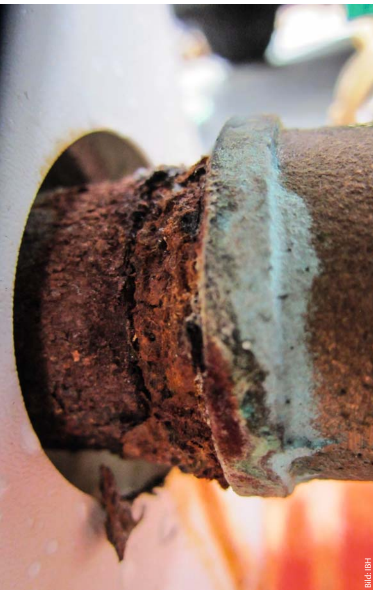
Schadensbild 2: Ein Trinkwasseranschluss nach nur zweijähriger Nutzung. Obwohl die Installation ansonsten handwerklich auf hohem Niveau erfolgt war, führte zu viel Hanf zu diesem Schaden
