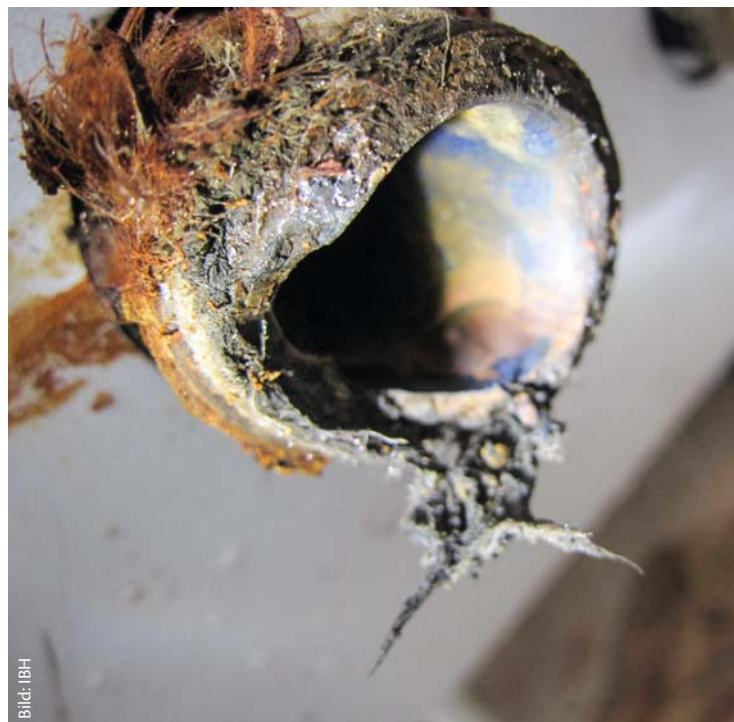
Schadensbild 3: Unter dem überdehnten T-Stück aus Schadensbild 2 kam dieser „abgefressene“, zöllige Rohranschluss zum Vorschein. Der Überschuss an Hanf war gut gemeint, aber letztlich „tödlich“
