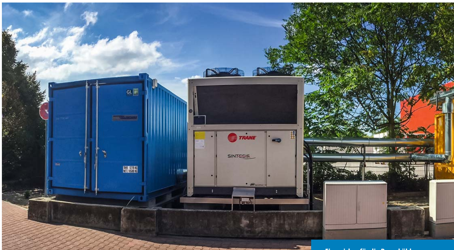
Bild: GA-tec Gebäude und Anlagentechnik GmbH
