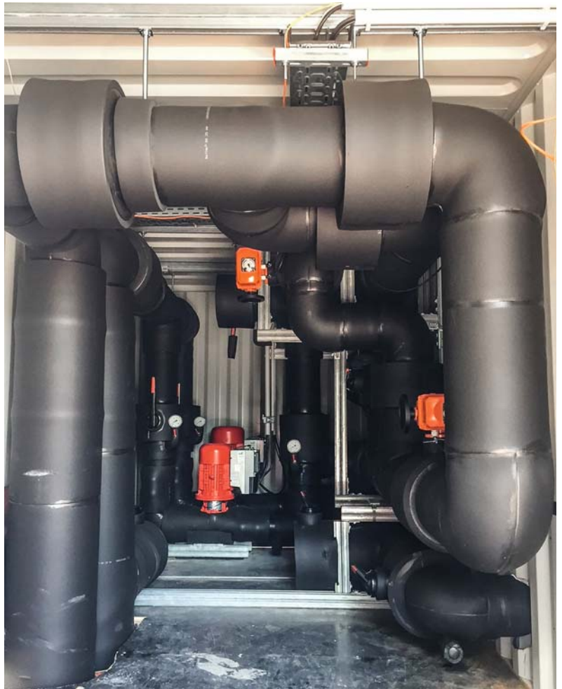
Bild: GA-tec Gebäude- und Anlagentechnik GmbH
