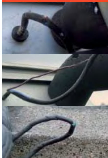
Abb. D.2.1-1 ungeschützte Fühlerkabel
