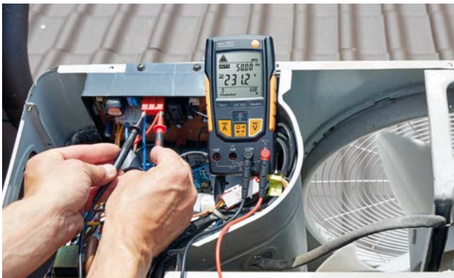
Spannungsmessung an einer Kälte-Außeneinheit mit testo 760 .
