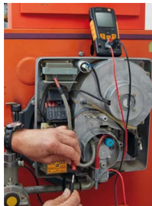
Aufbau der Ionisationsstrom-messung.
