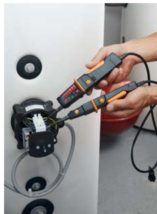
Spannungsmessung an einem Heizlastspeicher.
