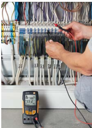
Spannungsprüfung am Schalt-schrank.
