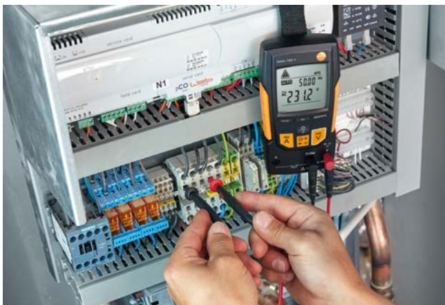
Spannungsprüfung am Schaltfeld einer Wärmepumpe.
