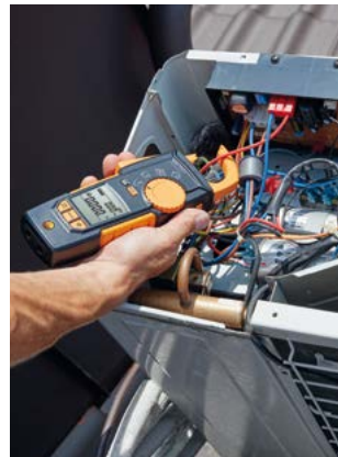
Einfädeln der Stromzange an einer Kälte-Außeneinheit.
