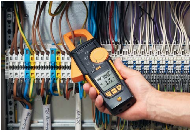
Strommessung am Schaltschrank.
