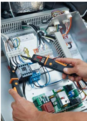
Spannungsmessung an einem Verdichter.
