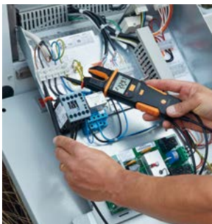
Spannungsmessung an einem Verdichter.
